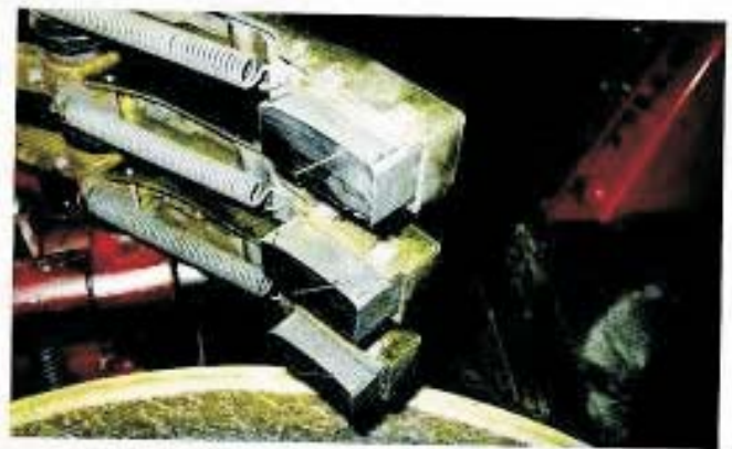
Reduzierter Verschleiß: Die homogene Stromverteilung in den Bürsten führt zu Verschleißraten von etwa 1 mm/1 000 Betriebsstunden, das bedeutet Bürstenstandzeit bis zu 32 000 Betriebsstunden.
